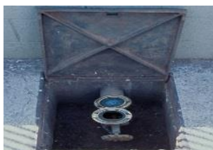
Registro de Recalque
